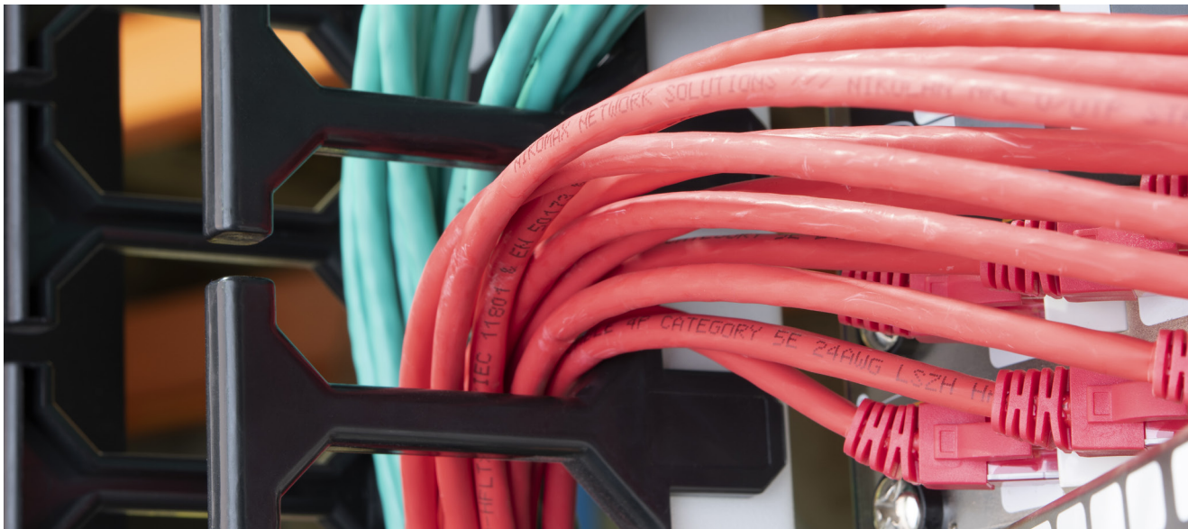
Разведение кабеля через TLK-OV70-XXU-ZZ
