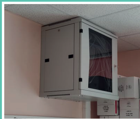
Наполненный шкаф TLK, расположенный в помещении диспансера
