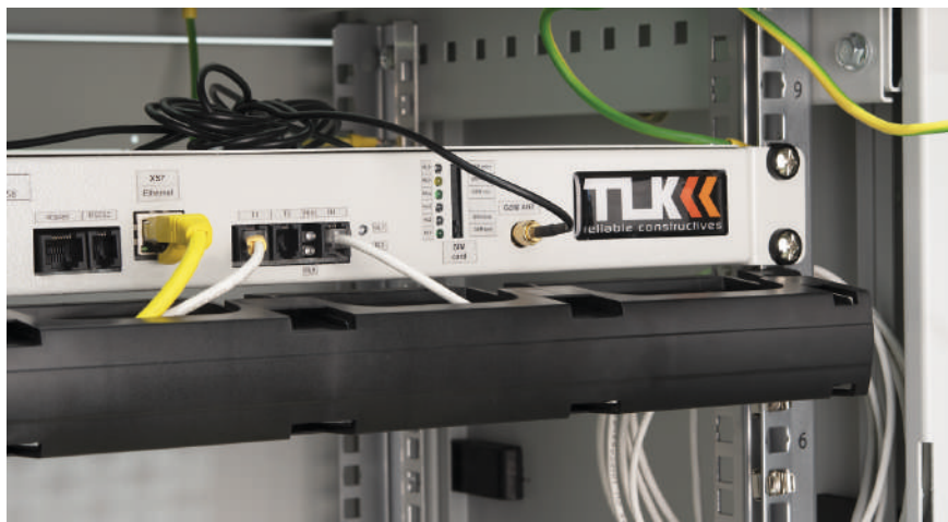
Установленная система мониторинга TLK
