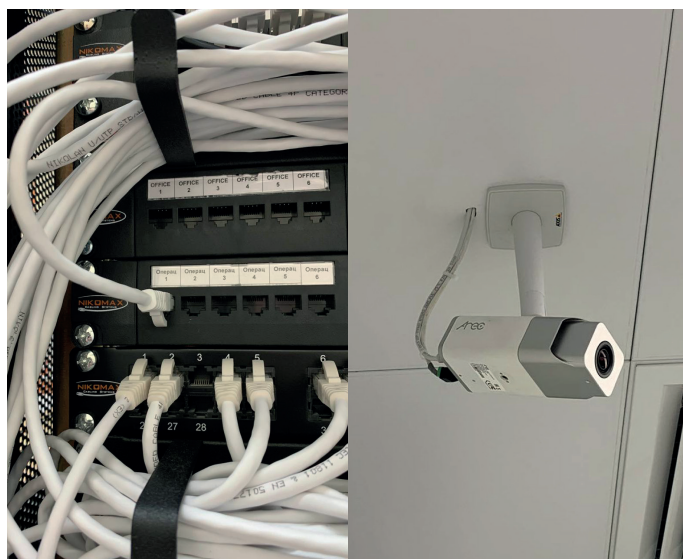
Установленное оборудование: NIKOMAX и AREC
