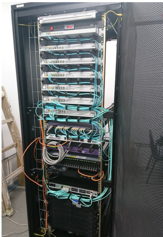
Шкаф TLK с оборудованием
