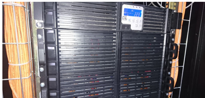
ИБП GIGALINK в работе
