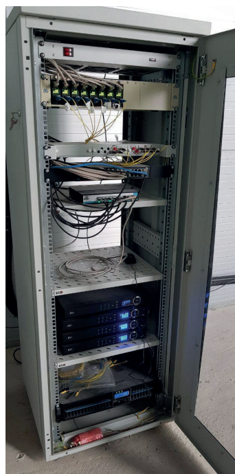
Телекоммуникационный шкаф TLK Lite с оборудованием
